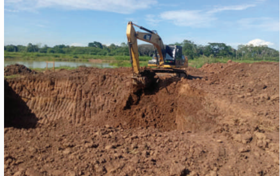
งานจัดเตรียมพื้นที่หน้างานและขุดบ่อพักน้ำ
