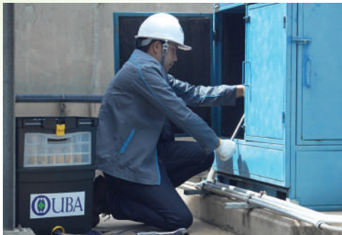
การตรวจสอบการทำงานตามแผนงาน การบำรุงรักษาเชิงป้องกัน (Preventive Maintenance)
