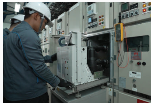
การตรวจสอบการทำงาน ของระบบไฟฟ้า
