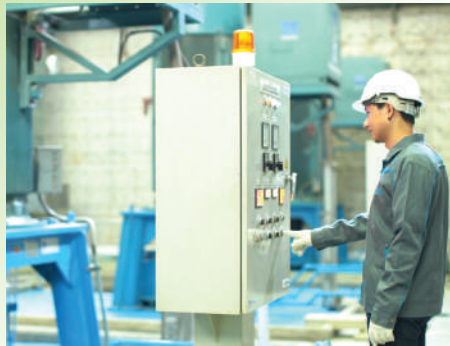
การตรวจสอบตั้งค่างานระบบไฟฟ้า
